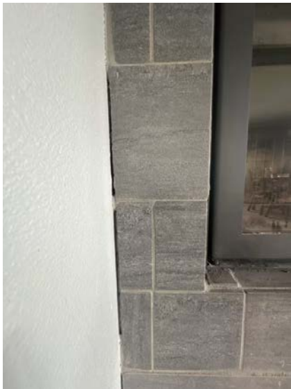
Noe gjenstående arbeid ved overgang/ avslutninger.
