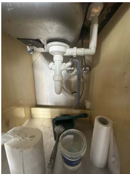
Viser vann og avløpsinnstallasjoner under kum.
