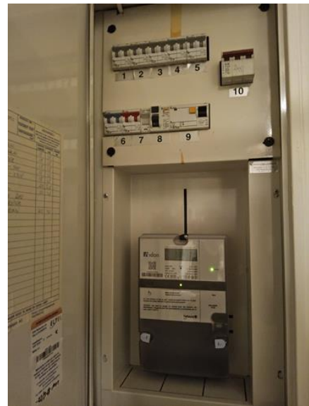
Elektrisk anlegg - [Sikringsskap]
