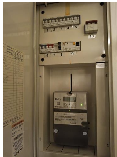
Elektrisk anlegg - [Sikringsskap ]
