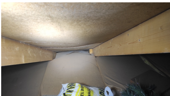
Begrenset ventilasjon i enkelte fakk.
