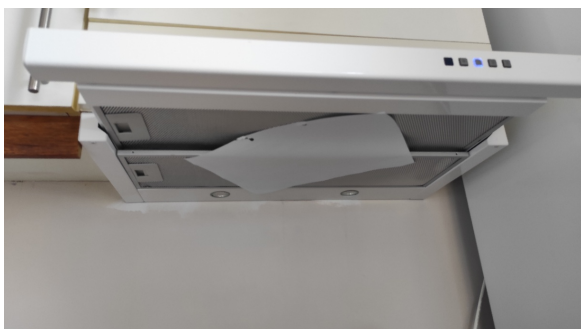
Funksjonstest av avtrekk.
