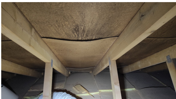
Svertesopp i undertak.
