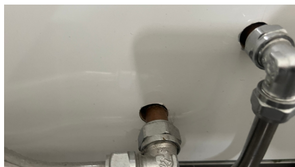
Eksempel på utette rørgjennomføringer
