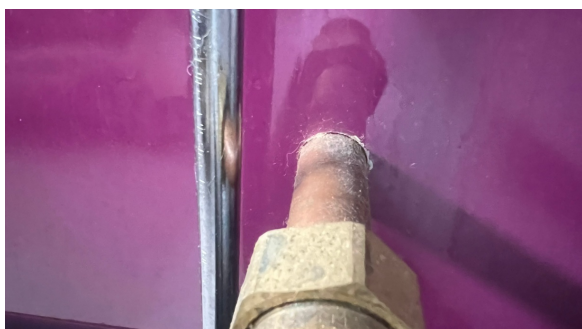
Eksempel på utette rørgjennomføringer
