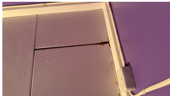
Fuktskader i himling som følge av feil oppbygging av rommet.
