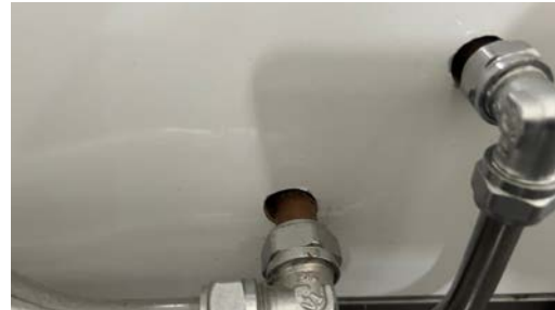
Eksempel på utette rørgjennomføringer
