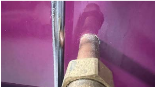
Eksempel på utette rørgjennomføringer
