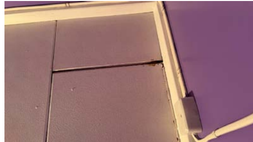
Fuktskader i himling som følge av feil oppbygging av rommet.
