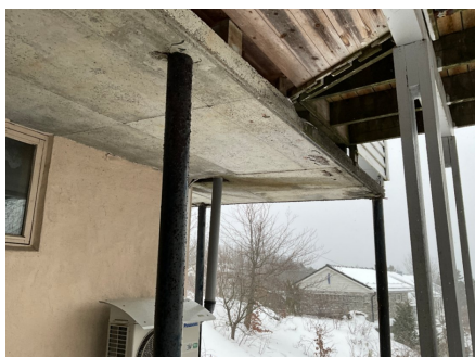
Eldre betongdekke henger løst.
