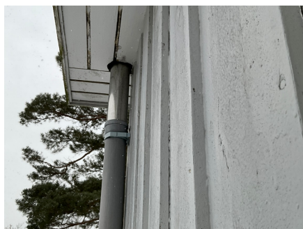
Nyere og eldre avløps deler.
