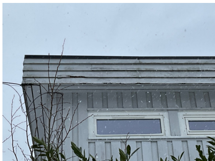
Råteskader i deler av kledningen.
