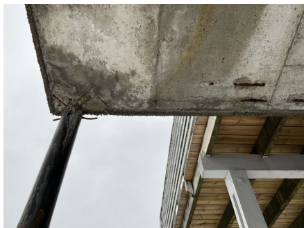
Stolpen er rustet og løs.
