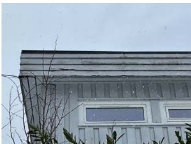
Råteskader i deler av kledningen.
