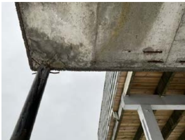
Stolpen er rustet og løs.
