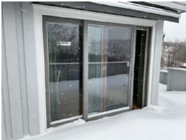
Fuktskader på dør og karm.
