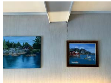
Sprekker innvendig i bygget, tyder på store bevegelser.
