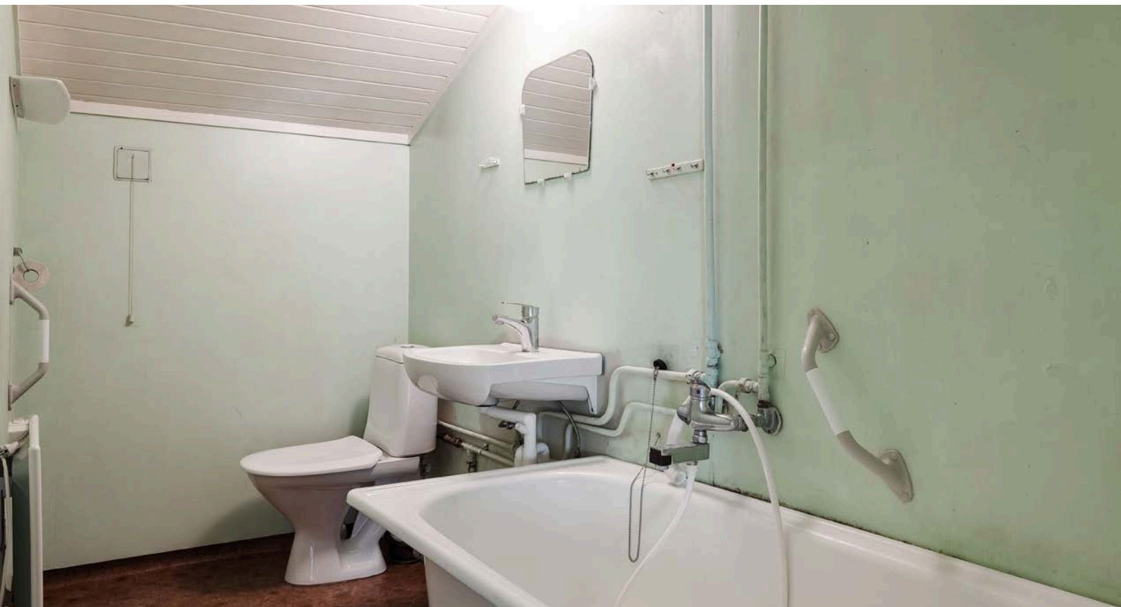
Eldre badrom fra 1950-tallet. Baderommet må totalrenoveres for å tåle normal bruk etter dagens krav.
