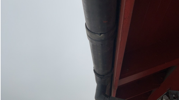
Lekkasje fra takrenne
