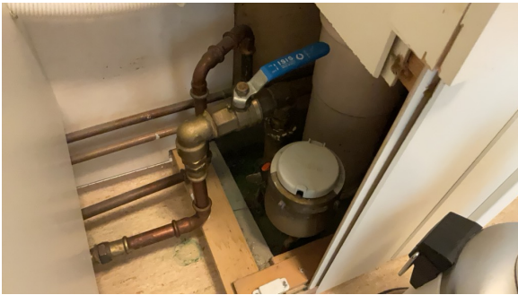
Stoppekran plassert på bad.
