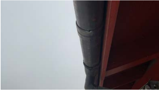
Lekkasje fra takrenne
