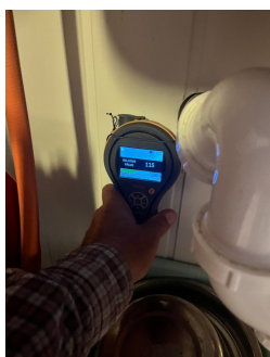
Ingen tegn til fukt med overflatesøk på vegger og gulv.
