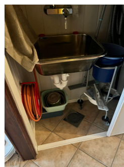
Bilde viser skyllekar og brannslange i gang ved kjøkken.
