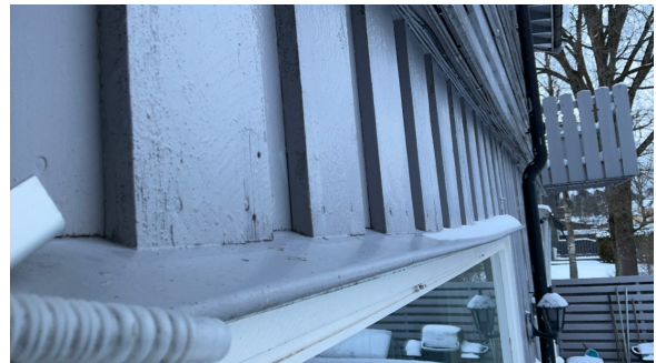
Ingen klaring mellom beslag og trekledning
