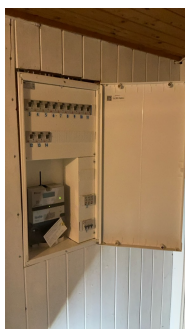
Sikringsskap med sikringsskjema via QR-kode
