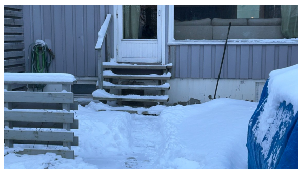
Manglende rekkverk på trapp fra terrasse til stue
