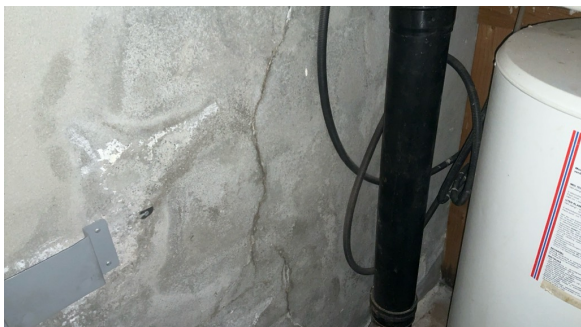
Sprekk på mur i innvendig bod
