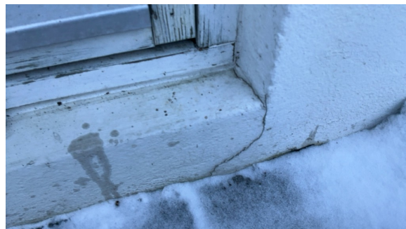
Riss i mur
