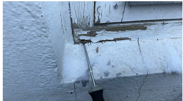
Antydning til råte på badevinduet
