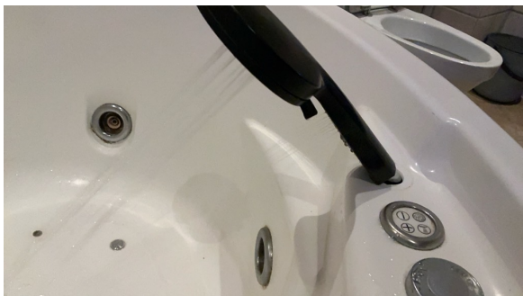
Lekkasje i hånddusj
