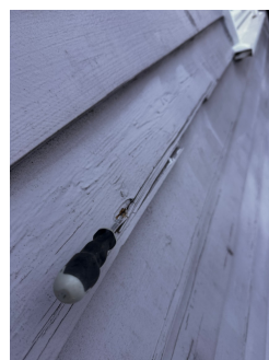
Råte og værslitt/opsprukket kledning
