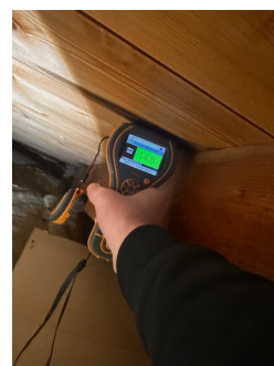
Ingen fuktighet i annen fuktskjolde
