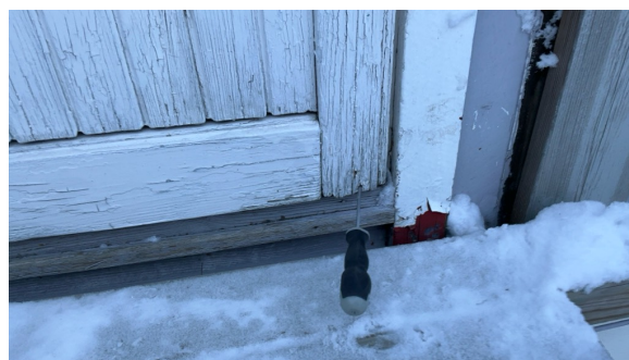
Råte i balkongdør 1.etg
