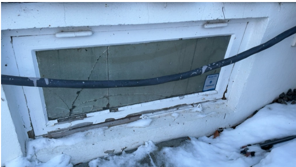
Sprukket glass i vindu til bod kjeller
