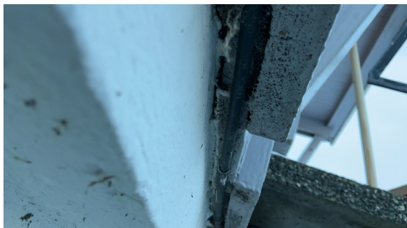
Ingen lufting bak kledning
