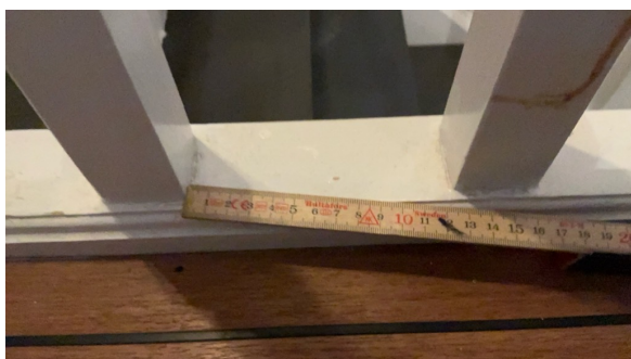
For stor åpning mellom rekkverkspiler i 2.etasje
