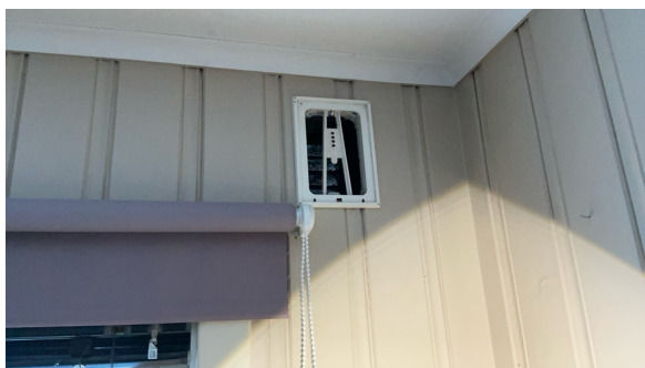
Mangler deksel på ventil
