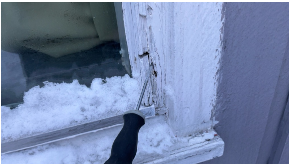
Råte på stuevinduet
