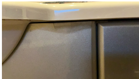
Svelling på innredning
