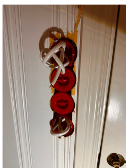
Bryterpanel på utsiden av bad i 2.etasje
