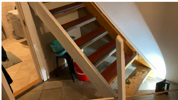
For stor åpning i rekkverk til kjellertrapp
