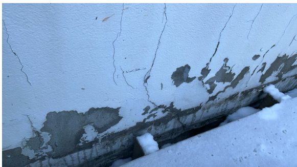
Riss og malingsflass på mur
