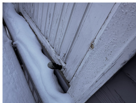
Råte i balkongdør 2.etg
