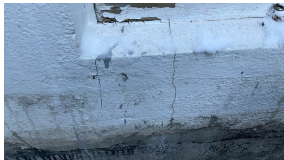
Riss i mur
