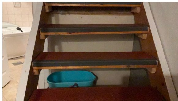
For stor åpning mellom trinn i kjellertrapp
