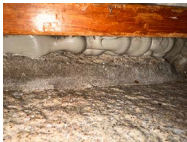
Bilde fra gangside, membran ikke synlig under terskel
