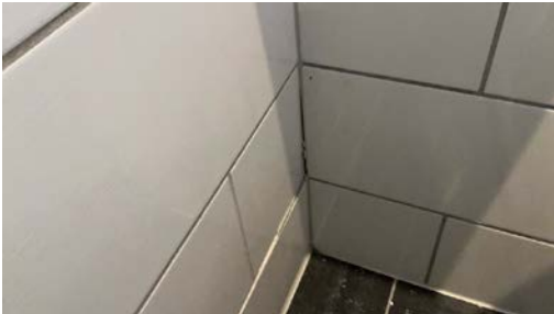
Flis på veggen som er noen millimeter trukket lenger inn i veggen, noe som har medført oppsprekking i silikofugen i hjørnet
