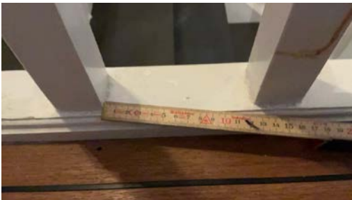
For stor åpning mellom rekkverkspiler i 2.etasje
