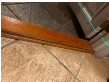
Membran ikke synlig ved terskel
