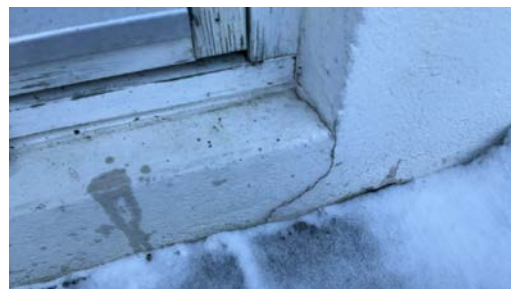
Riss i mur
