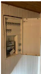
Sikringsskap med sikringsskjema via QR-kode
