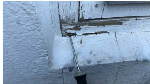
Antydning til råte på badevinduet
