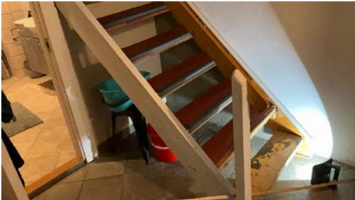
For stor åpning i rekkverk til kjellertrapp
