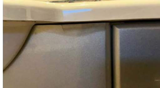
Svelling på innredning
