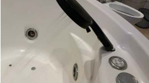
Lekkasje i hånddusj
