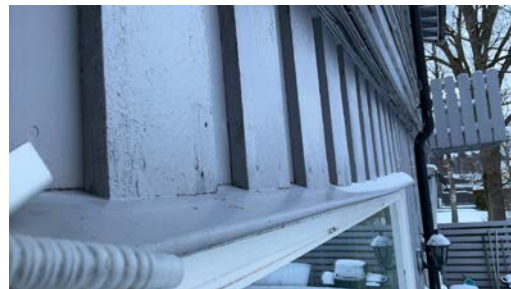
Ingen klaring mellom beslag og trekledning
