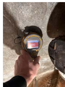
Indikasjoner på fukt ved fuktsøk på yttervegg av betong
