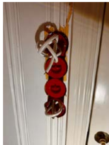
Bryterpanel på utsiden av bad i 2.etasje
