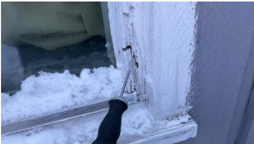
Råte på stuevinduet
