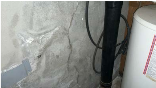
Sprekk på mur i innvendig bod
