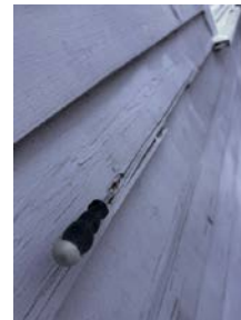
Råte og værslitt/opsprukket kledning
