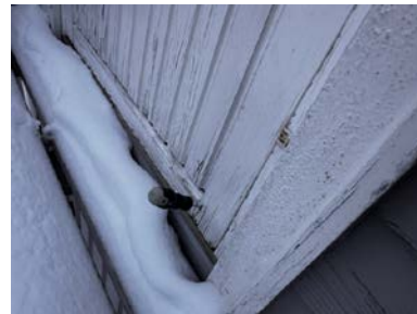
Råte i balkongdør 2.etg
