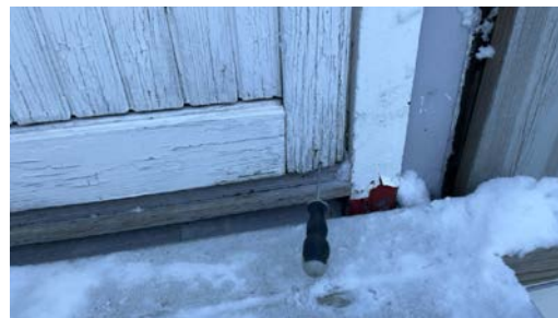
Råte i balkongdør 1.etg
