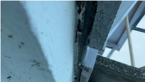
Ingen lufting bak kledning
