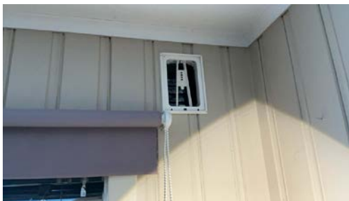
Mangler deksel på ventil
