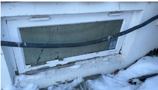
Sprukket glass i vindu til bod kjeller
