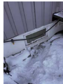
Løs kabel som ender under trapp til inngang
