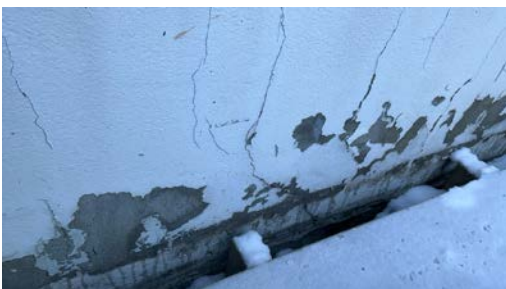
Riss og malingsflass på mur
