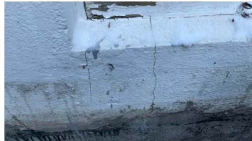
Riss i mur
