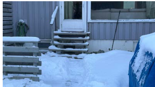
Manglende rekkverk på trapp fra terrasse til stue
