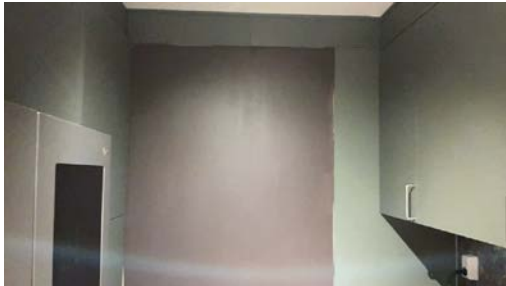
Dørhull som er tettet mot gang fra kjøkken
