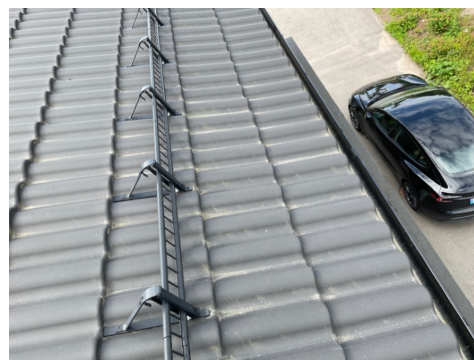
Snøfanger og takrenne
