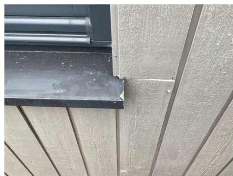
Løs bordkledning ved vindu
