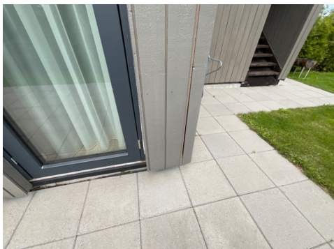
Løs bordkledning på hjørnet
