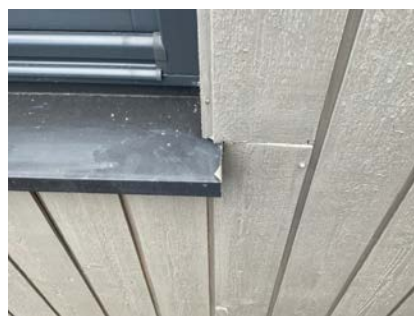
Løs bordkledning ved vindu
