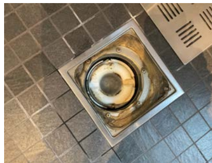
Sluk på baderom 2. etasje
