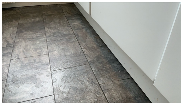
Fraglidning på gulv kjøkken.
