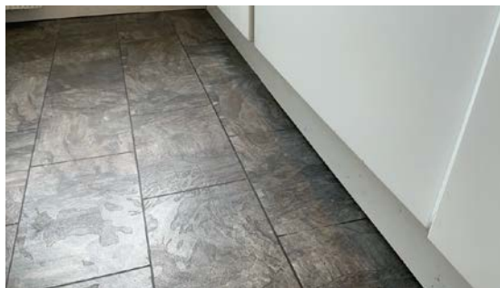
Fraglidning på gulv kjøkken.
