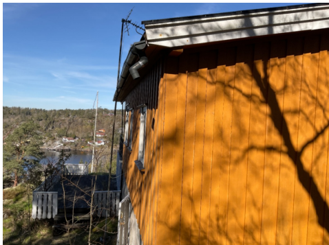
Takrenne og manglende nedlø
