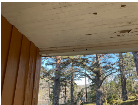
Råteskadet takkonstruksjon ved inngangspartiet.
