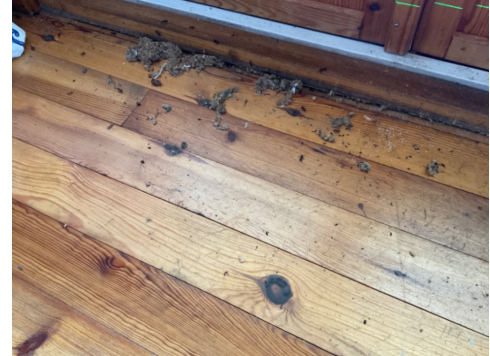
Deformasjon, svikt og store maur i bjelkelaget.
