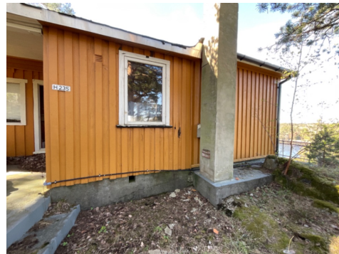
Råteskader i veggkonstruksjon og trepanel
