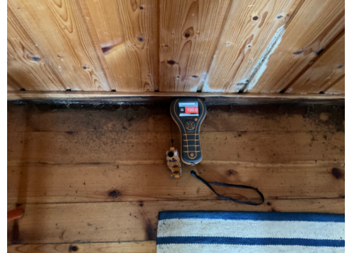
Fuktmåling i yttre vegg på kjøkkenet
