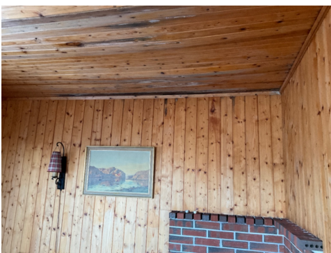
Skadet innvendig trepanel etter lekkasje i taket.
