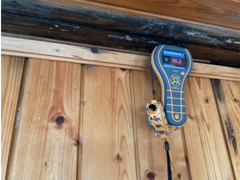
Fuktmåling i stuetaket
