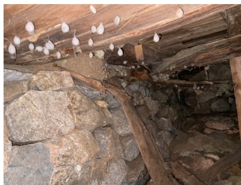
Råteskadet bjelkelag under terrassedør i krypkjeller
