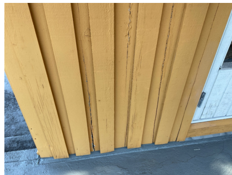
Sprukket trepanel på terrassen
