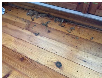
Deformasjon, svikt og store maur i bjelkelaget.
