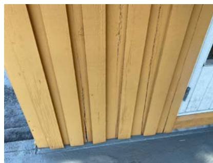
Sprukket trepanel på terrassen
