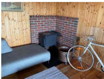
Ovn i stuen og brannmur
