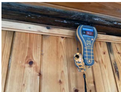
Fuktmåling i stuetaket
