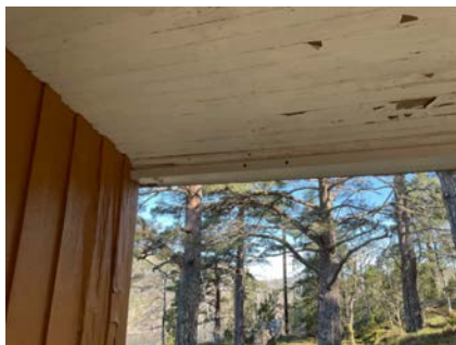
Råteskadet takkonstruksjon ved inngangspartiet.
