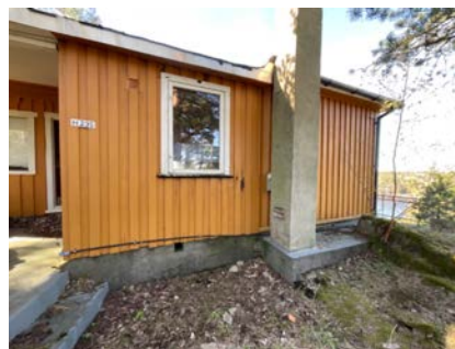
Råteskader i veggkonstruksjon og trepanel
