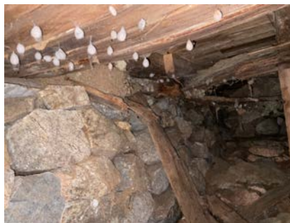
Råteskadet bjelkelag under terrassedør i krypkjeller
