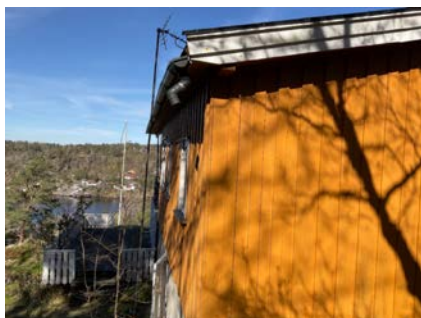
Takrenne og manglende nedlø
