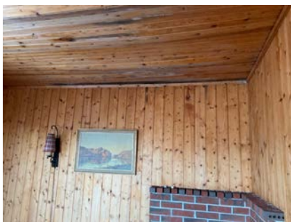
Skadet innvendig trepanel etter lekkasje i taket.
