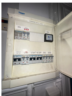
Sikringsskap med automatsikringer.
