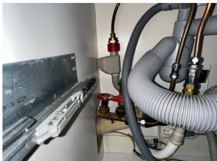
Eldre vanntilførsel på kjøkken
