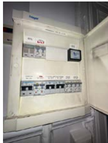
Sikringsskap med automatsikringer.
