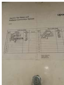
Kursoversikt for rør i samleskap
