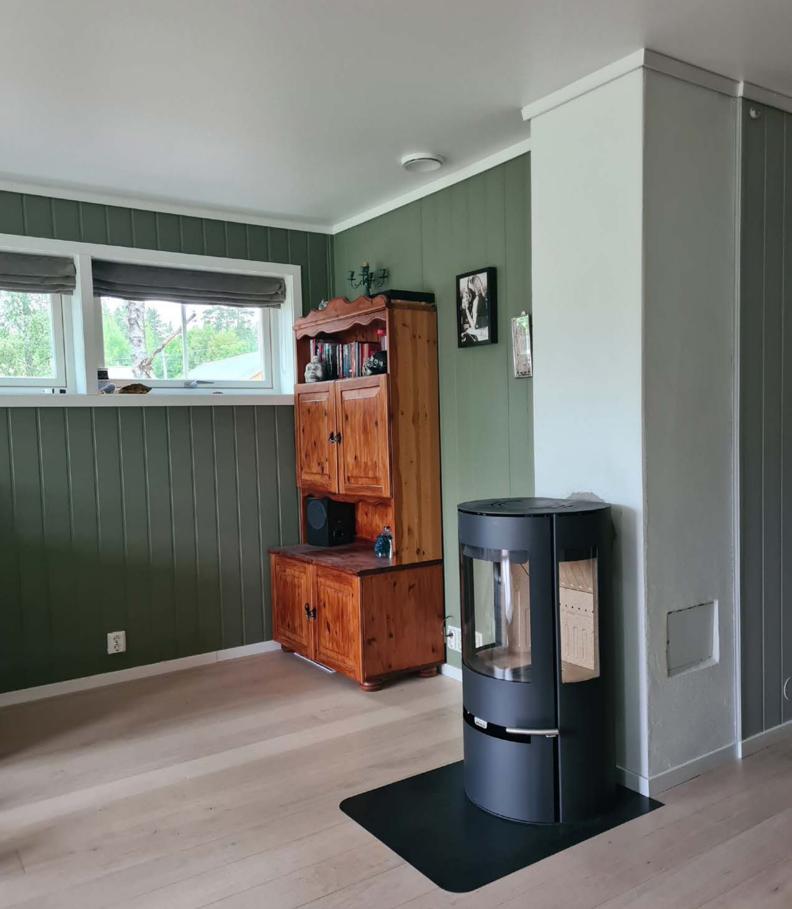
Boligen varmes blant annet opp med vedfyring. Ovnens ble installert i 2024.
