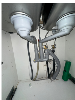
Røropplegg i kjøkkenbenk med Waterguard
