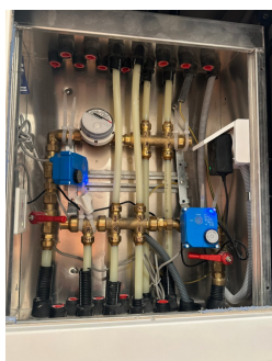
Samleskap med rørkurser og stoppekraner
