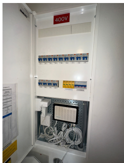
Sikringsskap med automatsikringer.
