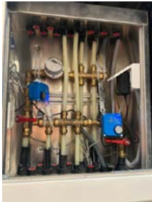
Samleskap med rørkurser og stoppekraner
