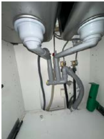
Rørøpplagg i kjøkkenbenk med Waterguard
