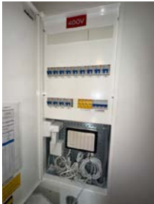
Sikringsskap med automatsikringer.
