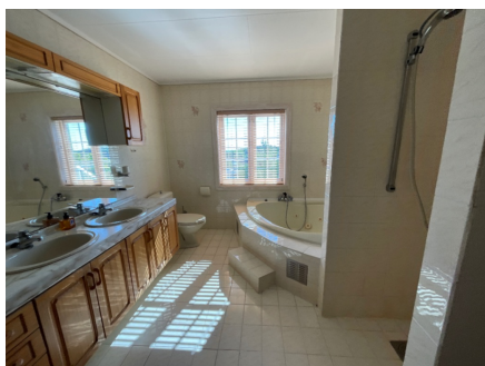
Sprekk i fliser i våtsoner.
