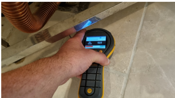
Forhøyde fuktverdier i gulv.
