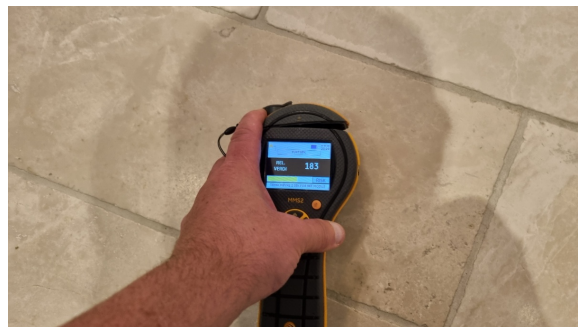
Ingen unormale fuktverdier på resterende del av gulvet.
