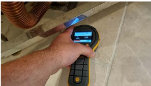
Forhøyde fuktverdier i gulv.
