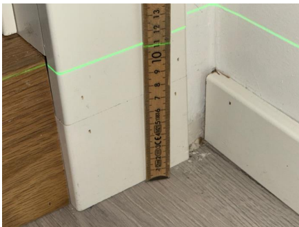
Høydeforskjell - målt ca. 110 mm ved badersromsvegg
