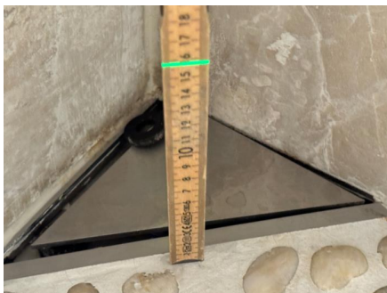
Fallforhold ca. 158 mm topp slukrist i dusjsone
