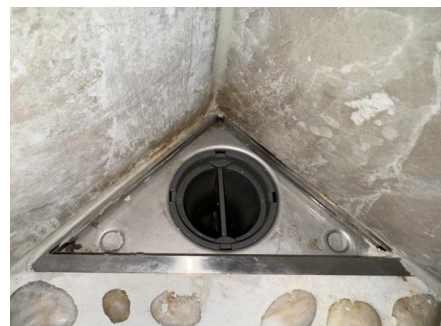
Hjørnesluk i dusjsone
