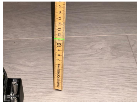
Høydeforskjell - målt ca. 113 mm midt på gulvet
