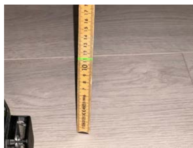
Høydeforskjell - målt ca. 113 mm midt på gulvet
