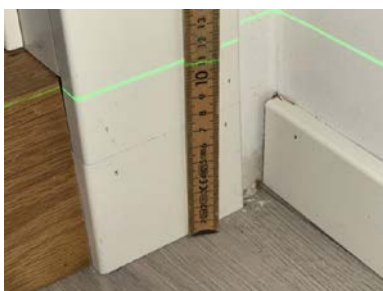
Høydeforskjell - målt ca. 110 mm ved baderomsvegg
