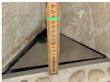
Fallforhold ca. 158 mm topp slukrist i dusjsone
