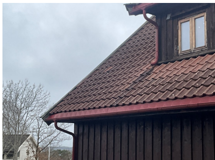
Enkelte stein ligger ikke ordentlig på plass.
