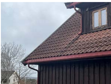
Enkelte stein ligger ikke ordentlig på plass.
