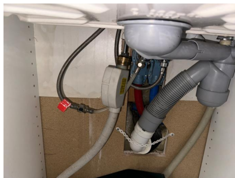
Røropplegg i kjøkkenbenk
