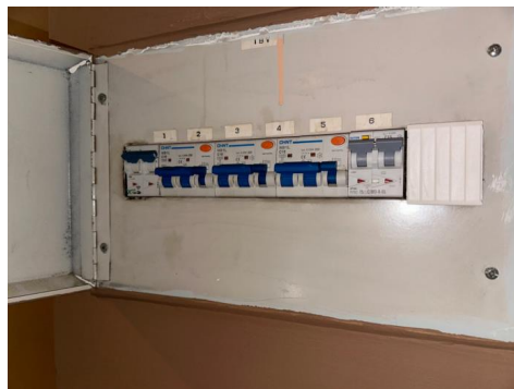
Sikringsskap med automatsikringer.
