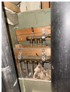
Samleskapstokk for vannrør på bad
