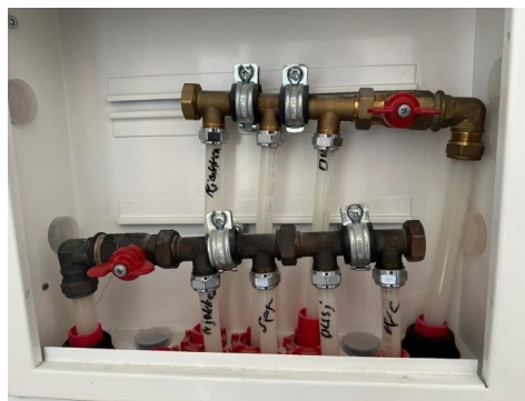
Samleskap for vannrør på bad
