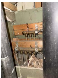
Samleskapstokk for vannrør på bad
