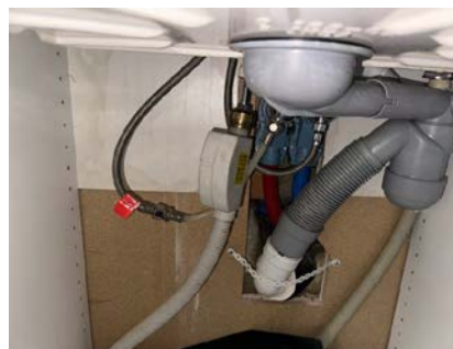
Rørapplegg i kjøkkenbenk
