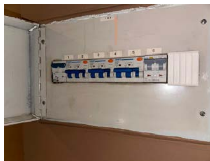
Sikringsskap med automatsikringer.
