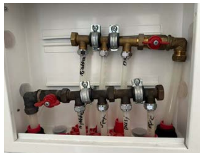
Samleskap for vannrør på bad
