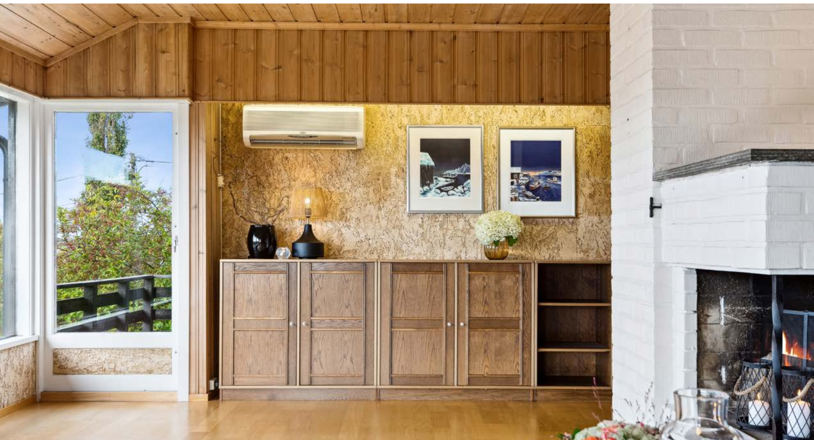
Varmepumpen tilfører jevn og behagelig varme til huset.
