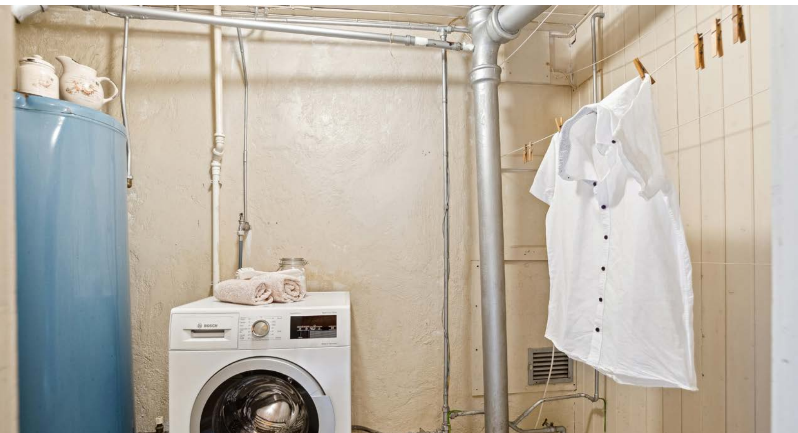
Boligen har et eget vaskerom i kjelleren, utstyrt med skyllekum og bereder på ca. 300 liter.
