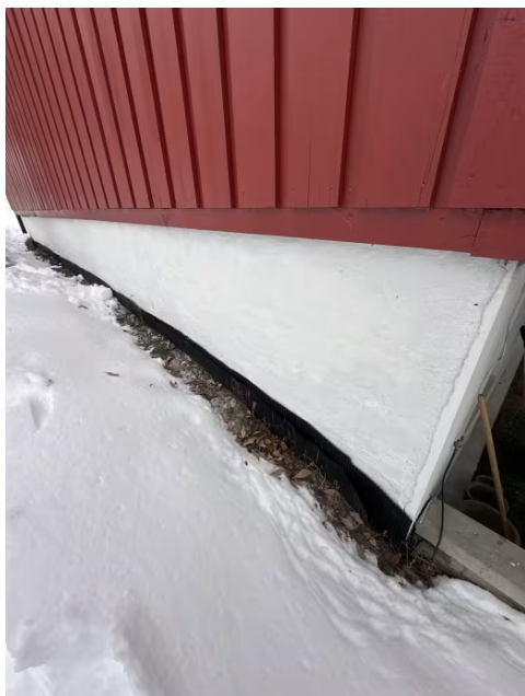
Viser grunnmursplast. Topplist/klemlist må etableres.
