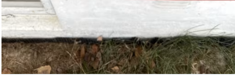
Viser sprekk i kledningsbord.
