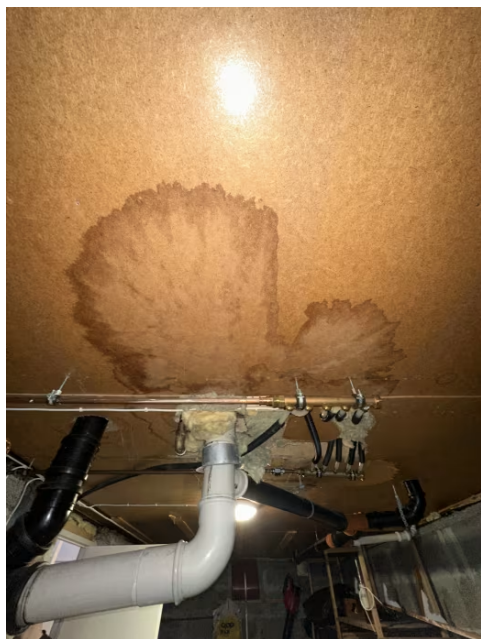
Viser skader i tak etter tidligere vannlekkasje fra kjøkken. Tørt på befaringen. Tak og overflater i bod anbefales oppgradert.
