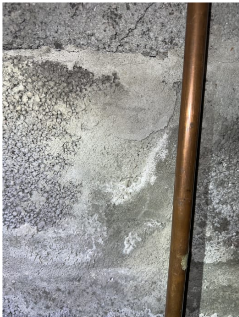
Viser saltutslag på veggen i kjeller.
