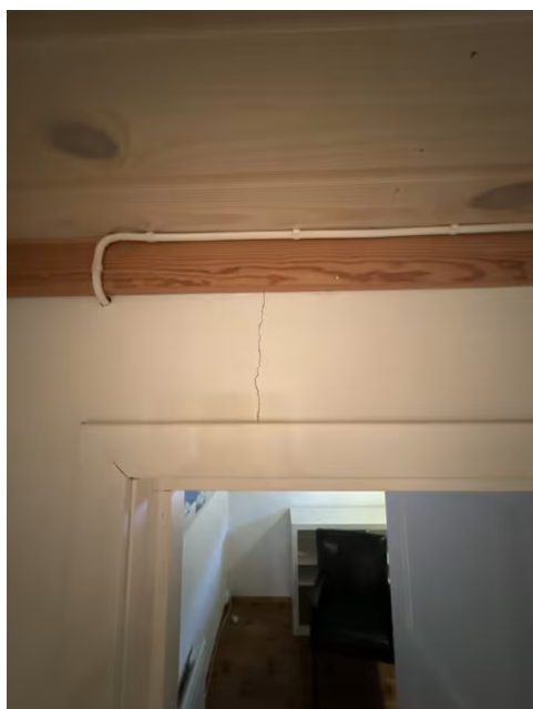
Viser sprekk over dør i kjeller.
