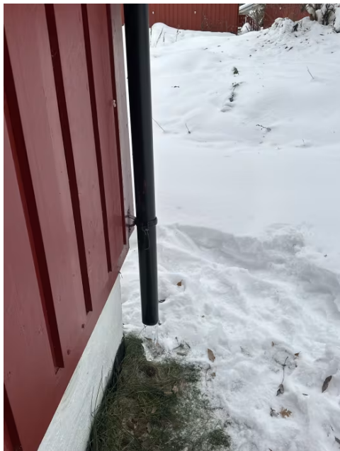
Viser taknedløp uten etablert utkast/drensledning. Drensrør anbefales montert slik at overflatevann blir ført bort fra bygningen.
