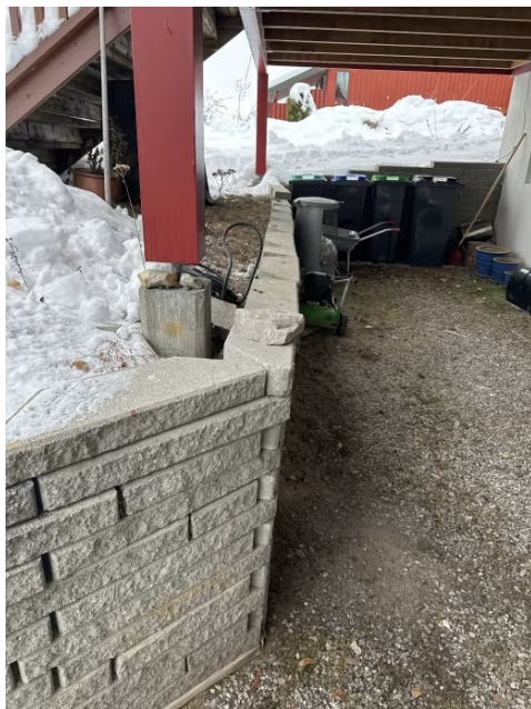
Viser skjevheter på støttemur ved inngang sokkel.
