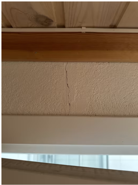
Viser sprekk over dør i kjeller.
