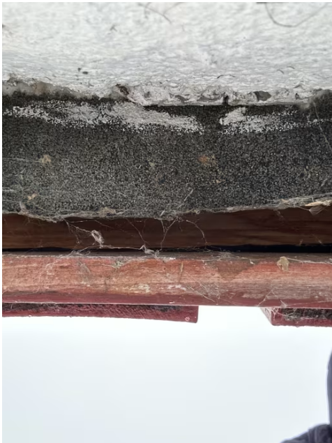
Veggkonstruksjon mangler lufting.
