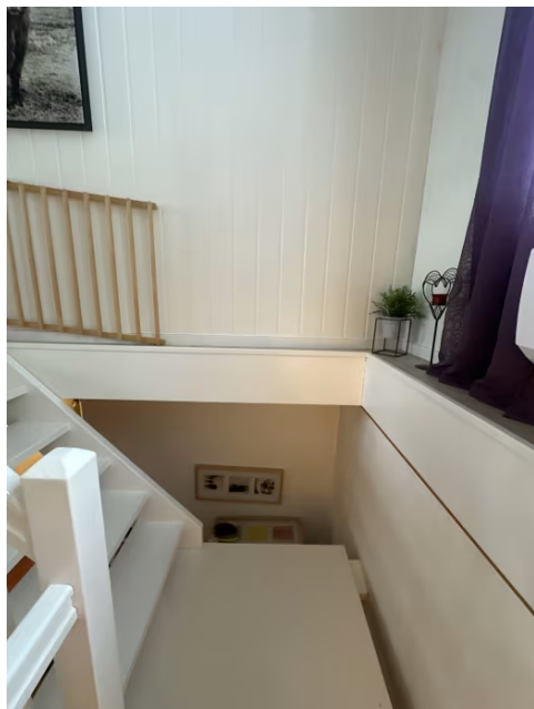
Åpning i trapp anbefales sikret med rekkverk.
