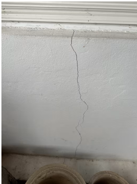
Viser eksempel på sprekker i grunnmur
