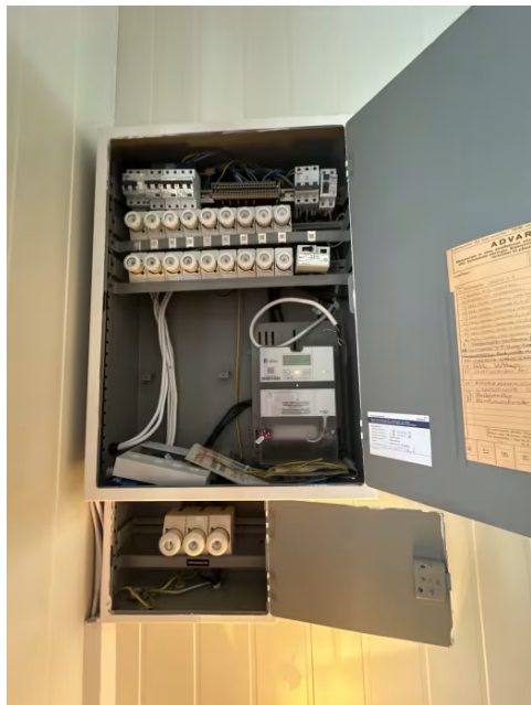
Viser sikringskapp, 3-fas inntak med 63 A hovedsikring, skrusikringer, jordfeilautomater og kursfortegnelse.
