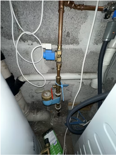
Viser vanninntak, vannmåler og hovedstoppekran.
