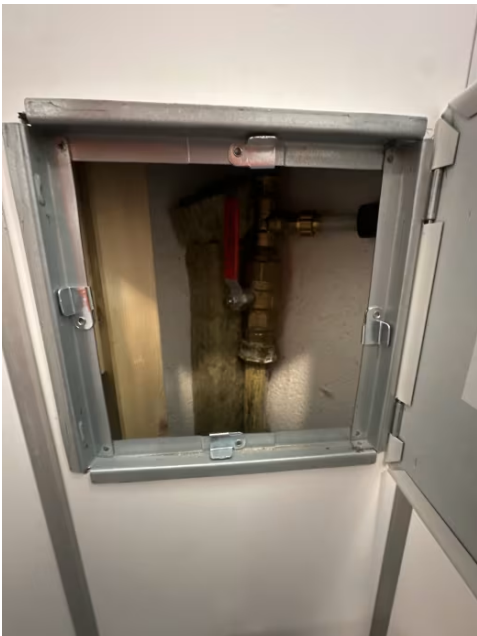
Avstengning av kaldtvann for bad i sokkeletasje med hovedstoppekran i luke på bad.
