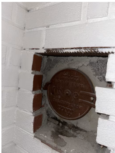
Sotluke plassert i kjeller på soverommet.
