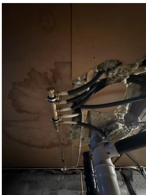
Viser åpen fordelerstokk plassert i tak.
