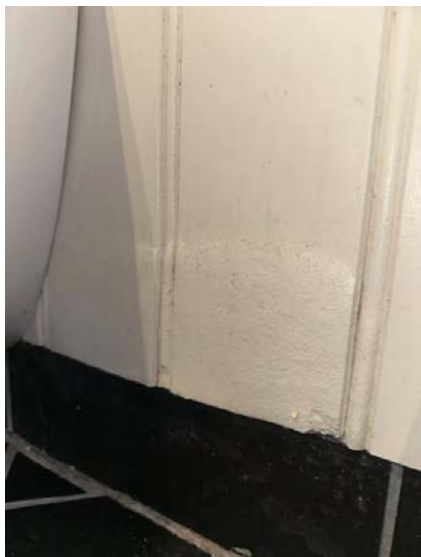
Viser eksempel på svelleskade på plater. Hjemmelshaver opplyser om skade fra tidligere eie. Tørt på befaringen.
