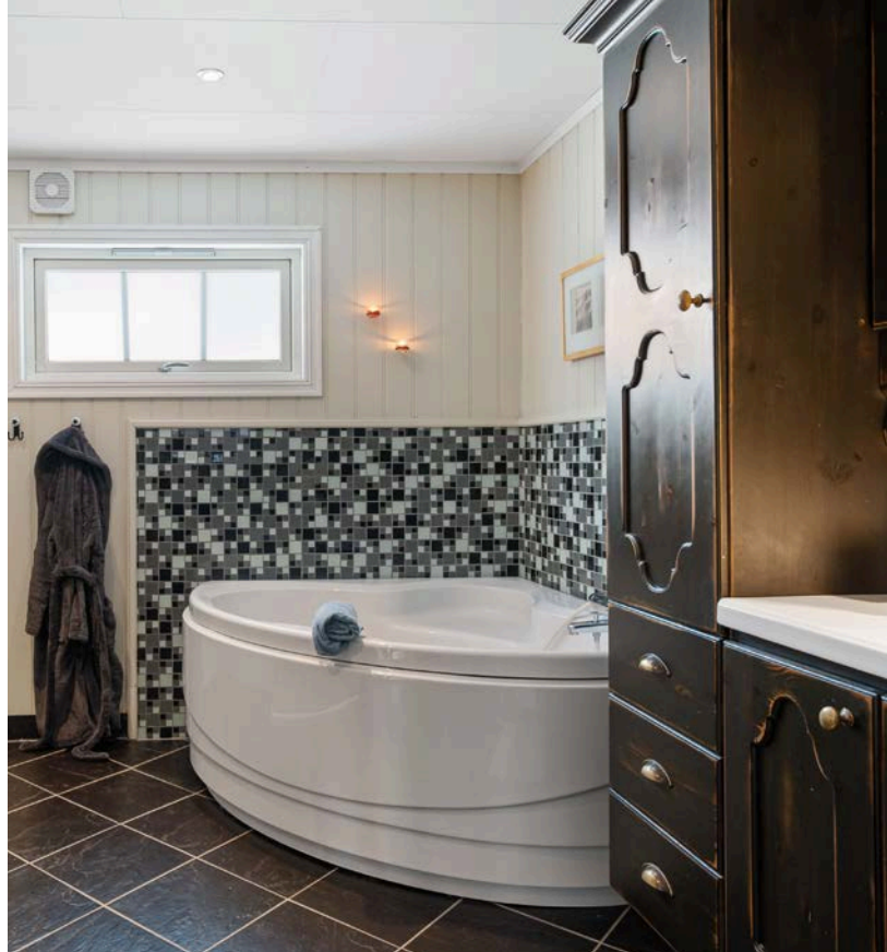
Installasjoner med badekar, dusjkabinett og toalett.
