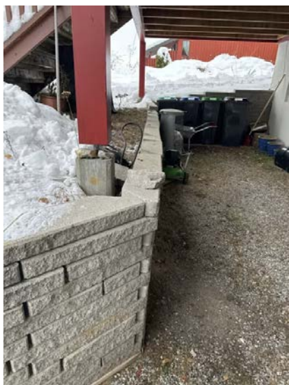
Viser skjevheter på støttemur ved inngang sokkel.
