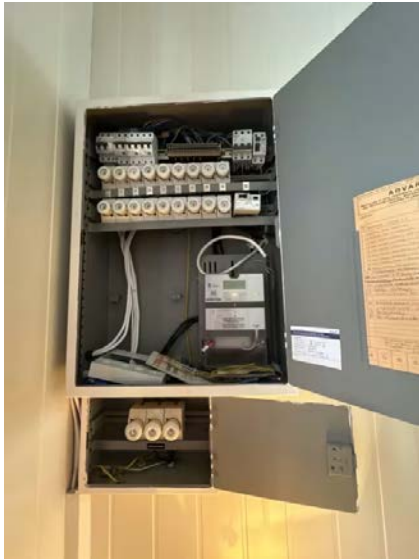
Viser sikringssskap, 3-fas inntak med 63 A hovedsikring, skrusikringer, jordfeilautomater og kursfortegnelse.
