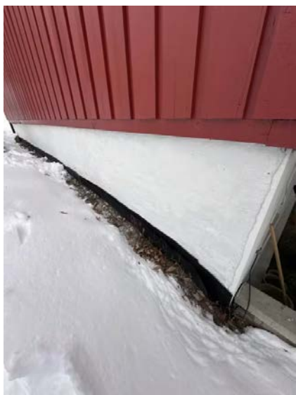
Viser grunnmursplast. Topplist/klemlist må etableres.
