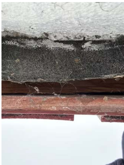
Veggkonstruksjon mangler lufting.
