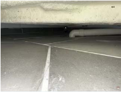
Det er ikke adgang til sluk slik at inspeksjon og kontroll av sluk kan ikke gjennomføres.
