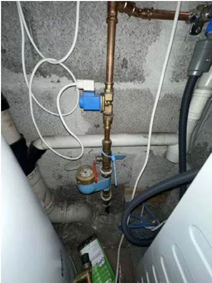
Viser vanninntak, vannmåler og hovedstoppekran.
