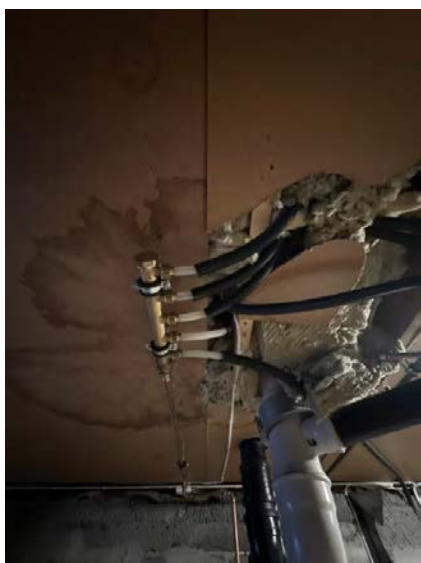
Viser åpen fordelerstokk plassert i tak.
