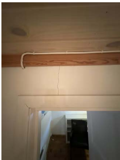
Viser sprekk over dør i kjeller.
