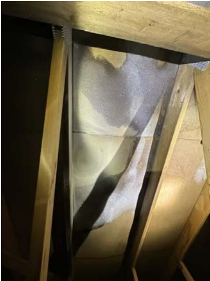
Viser rim og kondens mot undertak på loft.
