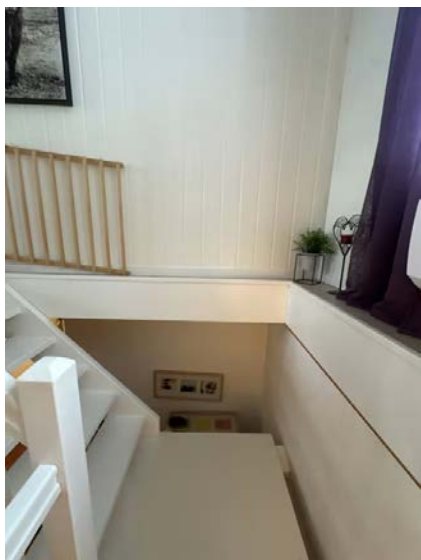
Åpning i trapp anbefales sikret med rekkverk.
