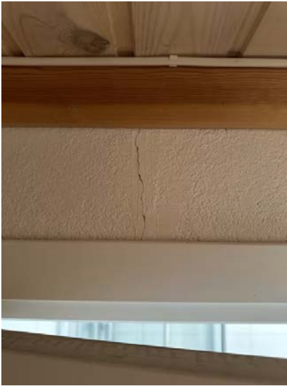
Viser sprekk over dør i kjeller.
