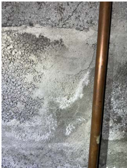
Viser saltutslag på veggen i kjeller.
