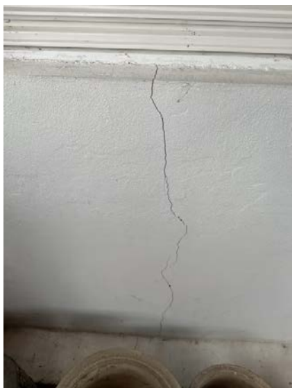
Viser eksempel på sprekker i grunnmur
