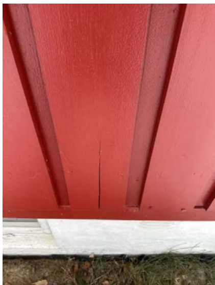
Viser sprekke i kledningsbord.
