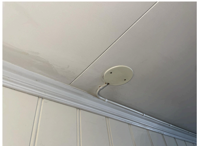
Misfarging i himling flere plasser.
