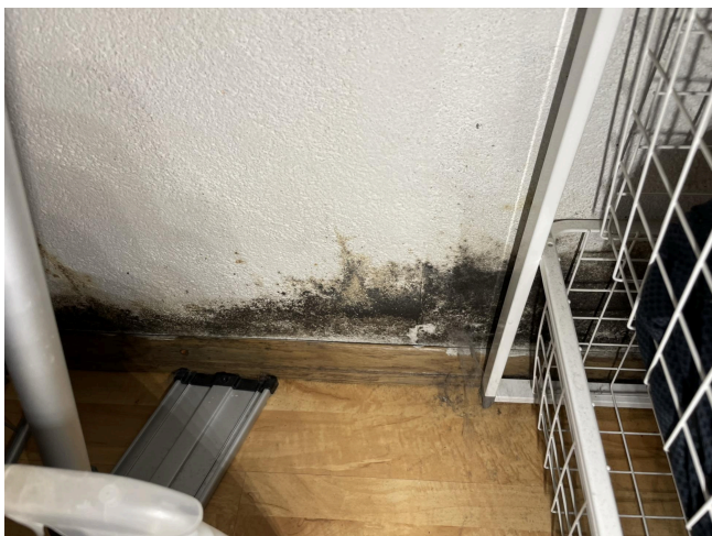
Svertesopp på murverk i garderobeskap.
