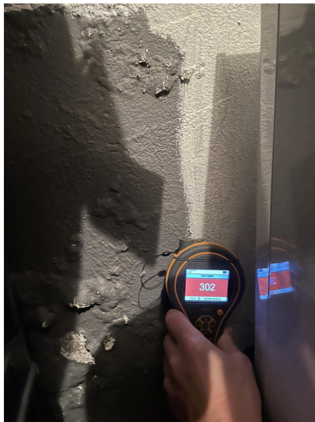
Fukt målt i vegg på bod.
