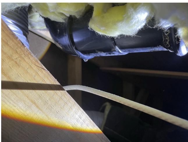
Kondens dryppende fra skjøt.
