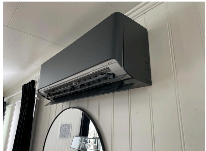
Luft til luft varmepumpe installert 2024.
