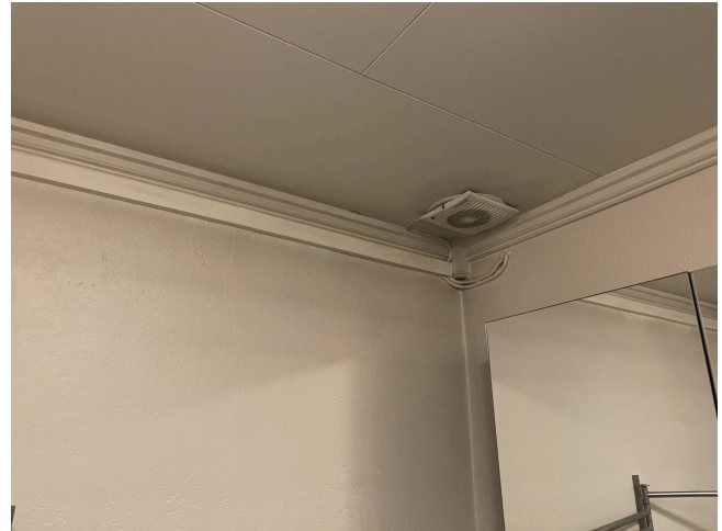
Misfarging takplate ved avtrekk.
