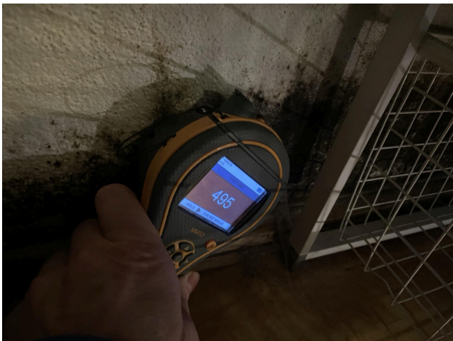
Påvist fukt i murverk.
