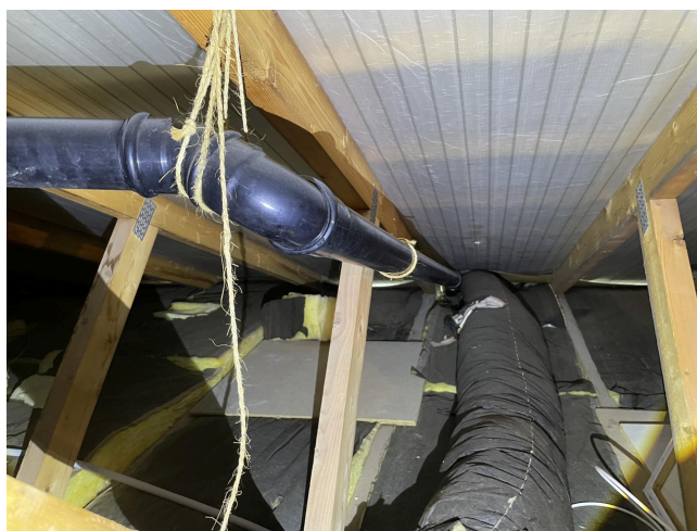
Uisolert lufferrør til avløp.
