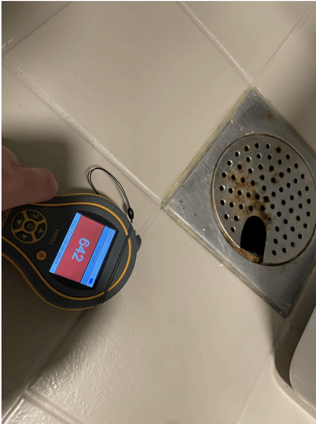
Fukt ved sluk bad.
