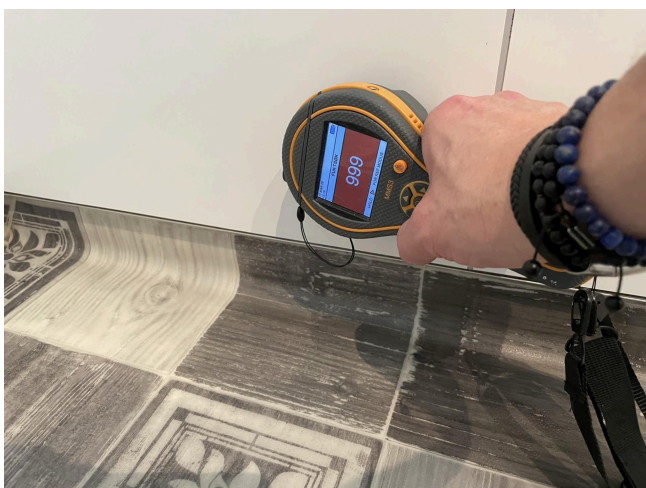
Fullt utslag på fukt med fuktindikator.
