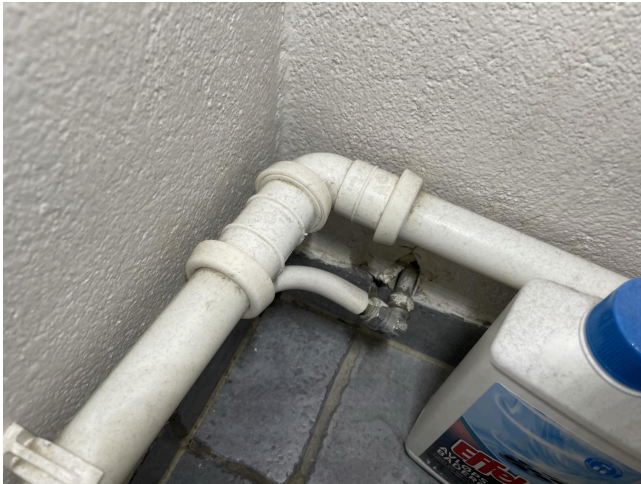
Synlige vann og avløpsrør.
