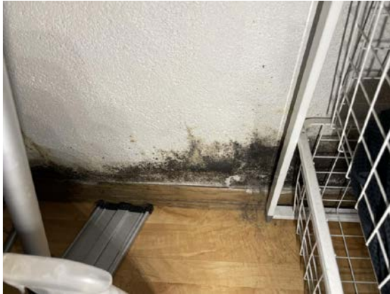
Svertesopp på murverk i garderobeskap.
