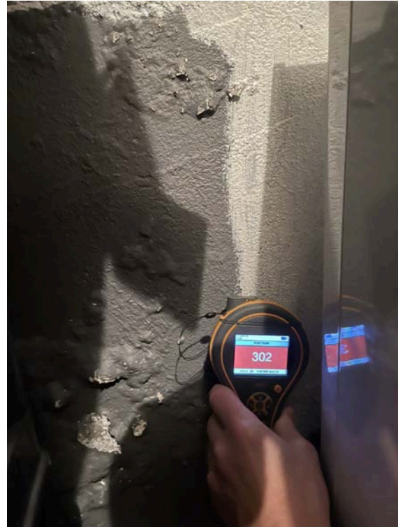
Fukt målt i vegg på bod.
