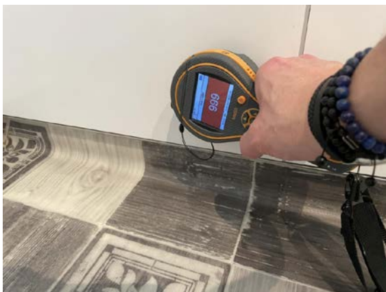
Fullt utslag på fukt med fuktindikator.
