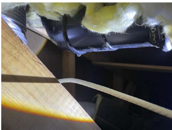
Kondens dryppende fra skjøt.
