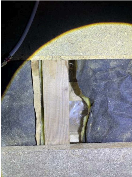
Hull i dampsperre.
