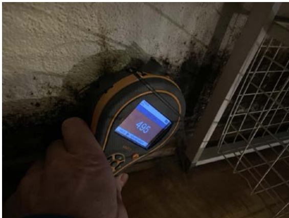
Påvist fukt i murverk.
