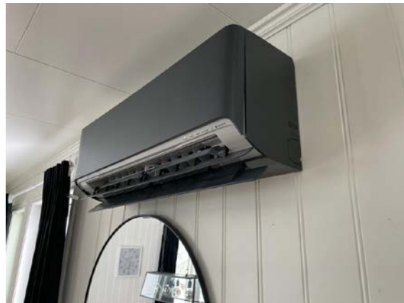
Luft til luft varmepumpe installert 2024.
