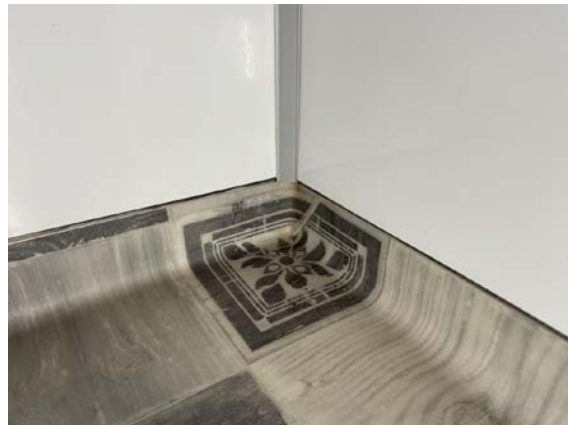
Manglende fuge i ende av våtromsplate i våtsone.
