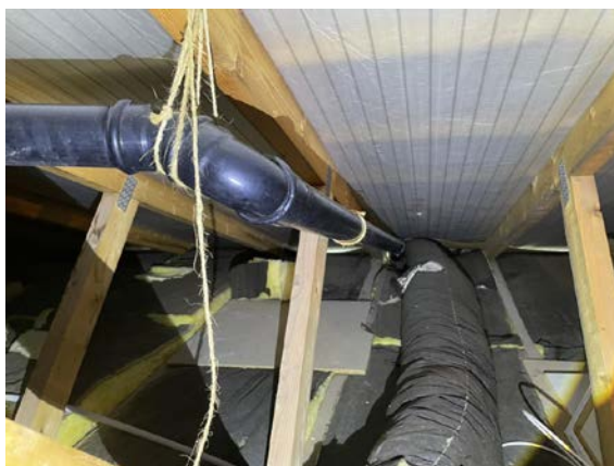
Uisolert lufteør til avløp.
