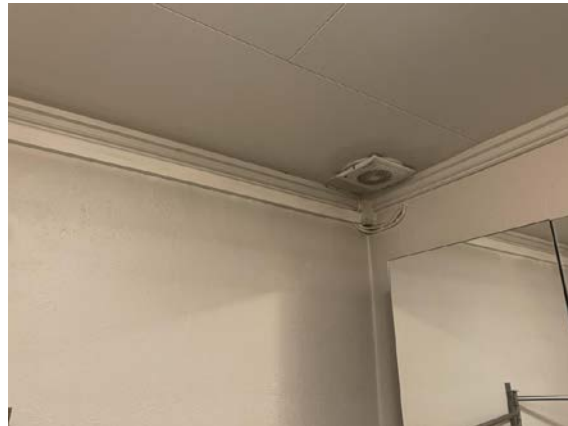
Misfarging takplate ved avtrekk.
