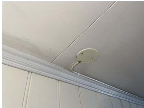
Misfarging i himling flere plasser.
