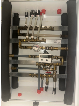
Samleskap med rørkurser og stoppekraner
