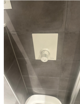
Regulator for vannbåren varme på bad
