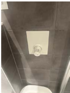
Regulator for vannbåren varme på bad
