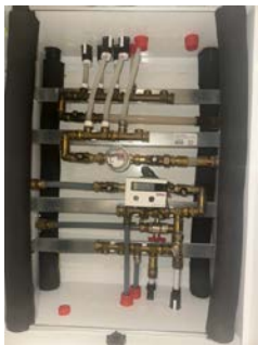
Samleskap med rørkurser og stoppekraner
