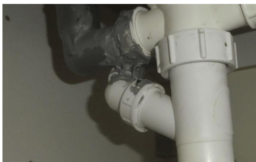
Silikon rundt skjøt i avløp under vask
