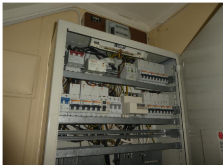
Manglende deksler i sikringskap
