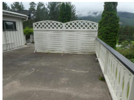
Levegg med slitasje
