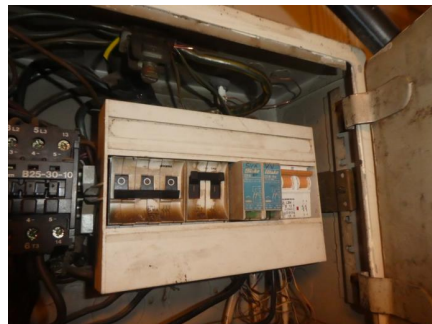
Sikringskap i garasje med svimerker under sikringer og manglende deksler
