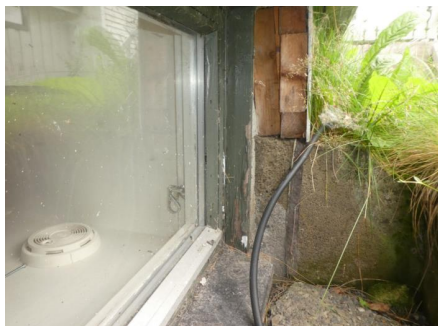
Utlekking for fasadeplater på grunnmur
