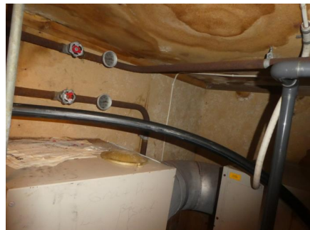
Fuktmerker i himling på teknisk bod ved basseng
