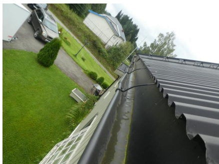
Deformasjoner i takrenner
