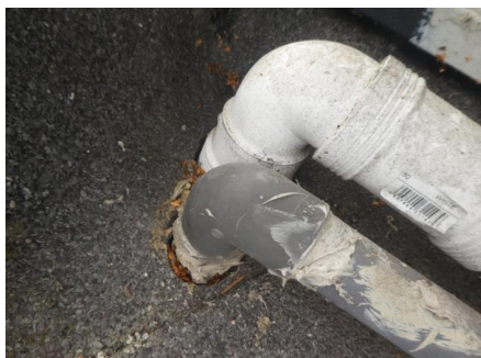
Utettheter grunnet ufagmessig tetting rundt gjennomføring i tak
