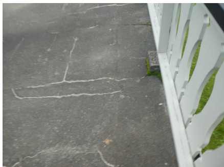
Gulvoverflater med sprekker
