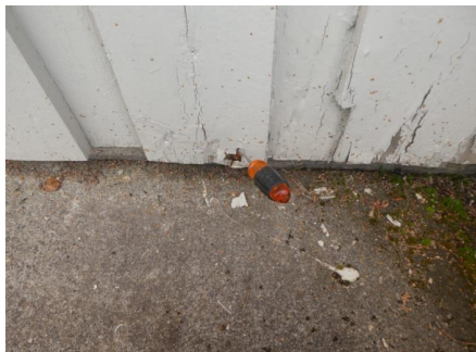
Råteskader i trekledning
