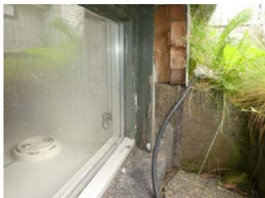
Utlekking for fasadeplater på grunnmur
