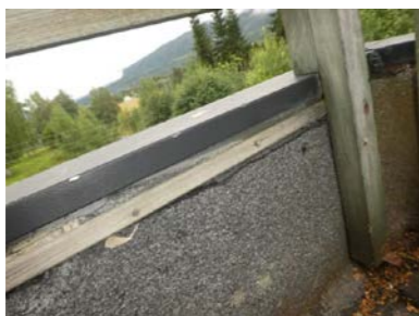
Ufagmessig avslutning av papp mot toppbord på veranda utenfor hybel
