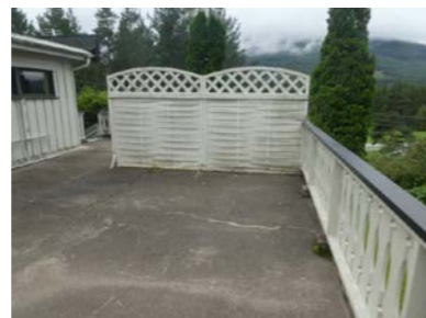
Levegg med slitasje
