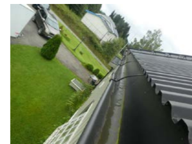
Deformasjoner i takrenner
