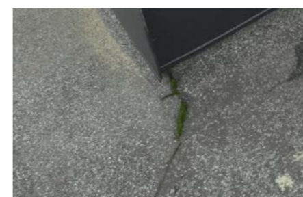
Sprekker i takpapp rundt pipe
