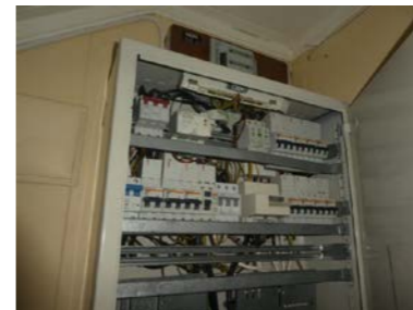
Manglende deksler i sikringsskap
