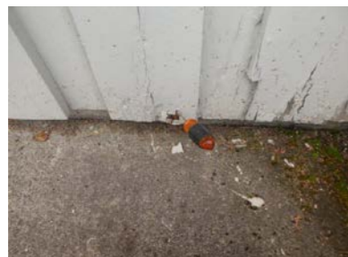
Råteskader i trekledning
