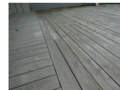
Skjevheter i platting
