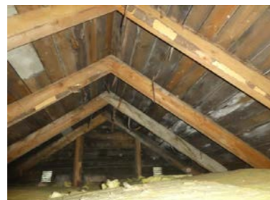
Sverting i undertak som antatt skyldes dårlig ventilering
