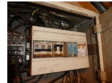
Sikringsskap i garasje med svimerker under sikringer og manglende deksler
