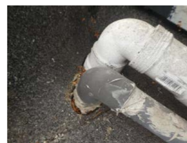
Uttetheter grunnet ufagmessig tetting rundt gjennomføring i tak
