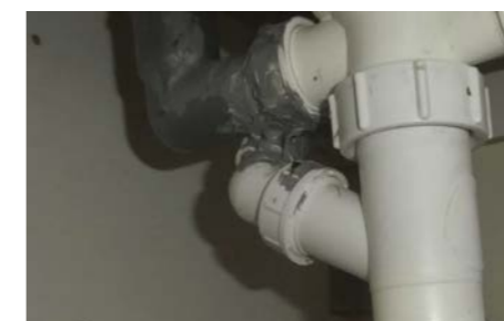
Silikon rundt skjøt i avløp under vask
