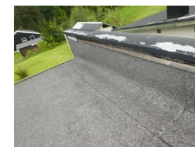
Ufagmessig utførelse av overgang mellom papp og beslag/dekkbord
