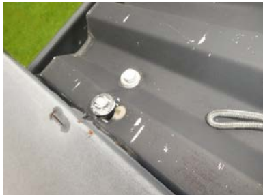
Utettheter rundt innfesting i taktekkingen.
