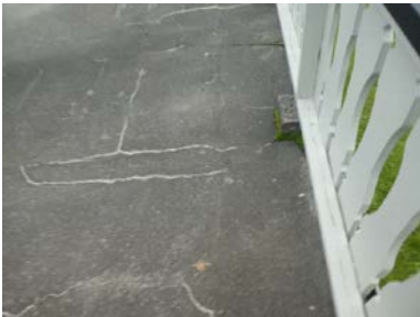
Gulvoverflater med sprekker
