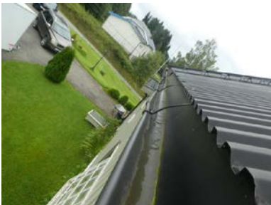
Deformasjoner i takrenner
