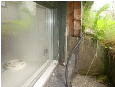
Utlekking for fasadeplater på grunnmur
