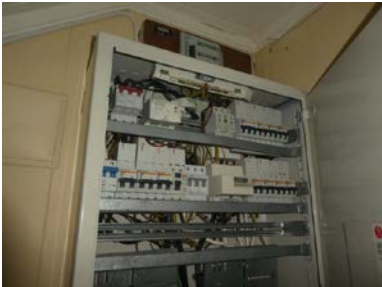
Manglende deksler i sikringsskap
