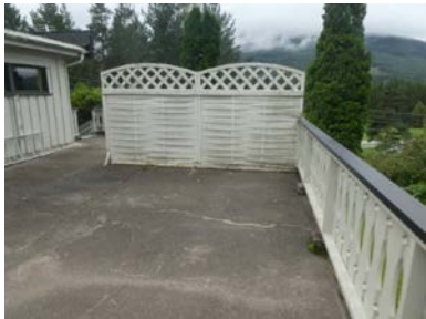
Levegg med slitasje
