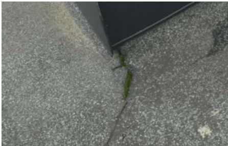
Sprekker i takpapp rundt pipe
