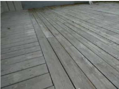
Skjevheter i platting
