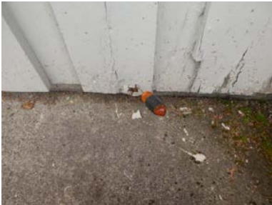
Råteskader i trekledning
