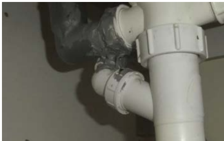
Silikon rundt skjøt i avløp under vask
