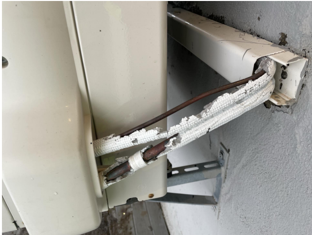
Isolering av rør til utedel varmepumpe 2008 er ødelagt.
