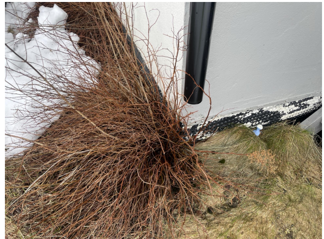
Bortledning av vann fra nedløp ikke tilfredsstillende. Nedløp avsluttet over terreng og rett ned ved grunnmur.
