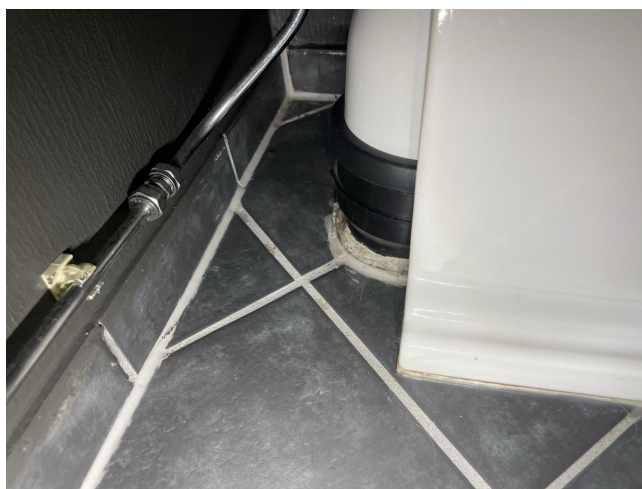
Gjennomføringer i våtsone gulv er ikke korrekt utført.
