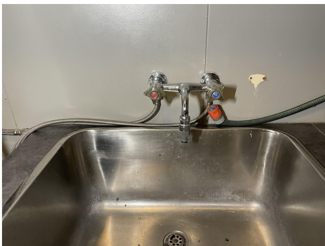
Våtsone vegg er ikke etablert.
