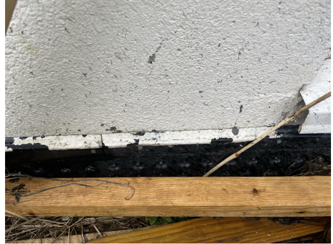
Overgangslist kapillærbrytende sjikt ikke pusset inn.
