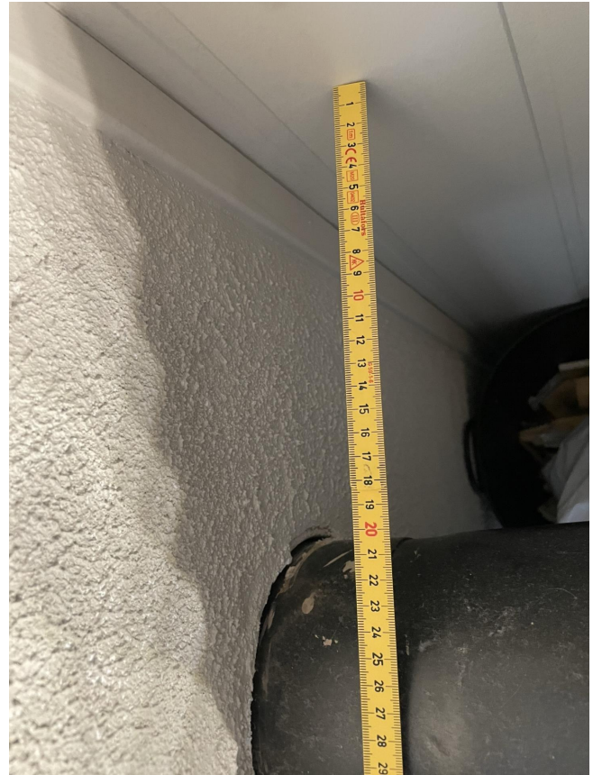
Avstand mellom uisolert røykrør og brennbart materiale er under 300mm.
