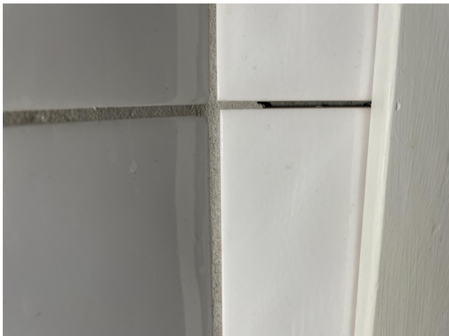
Manglende fuger i mellom keramiske fliser.
