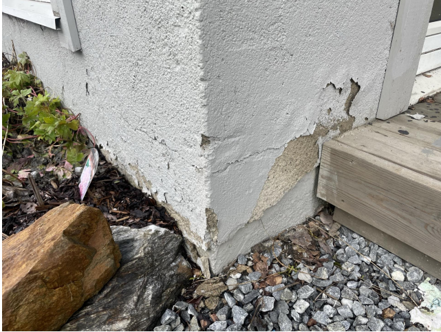
Avflassing og riss i overflate mur. Det mangler kapillærbrytende sjikt på konstruksjon mot terreng.
