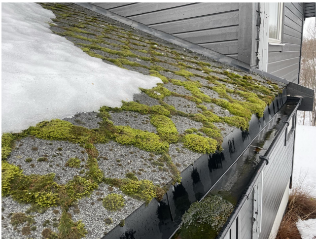
Det er påvist manglende vedlikehold på tekking. Det er påvist mose på taktekking.
