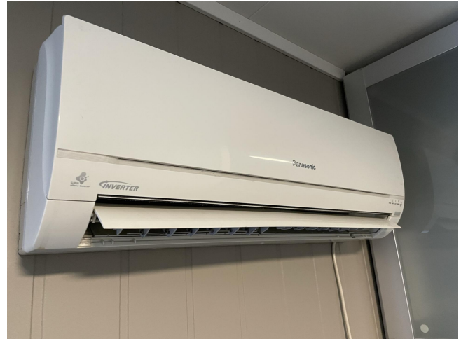
Luft-til-luft varmepumpe fra 2008 kjeller nærmer seg utløpsdato.
