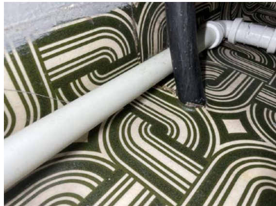
Gjennomføringer i våtsone gulv er ikke korrekt utført.
