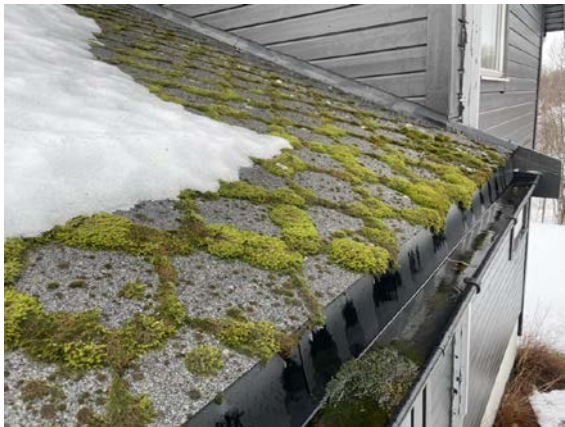
Det er påvist manglende vedlikehold på takting. Det er påvist mose på taktekking.
