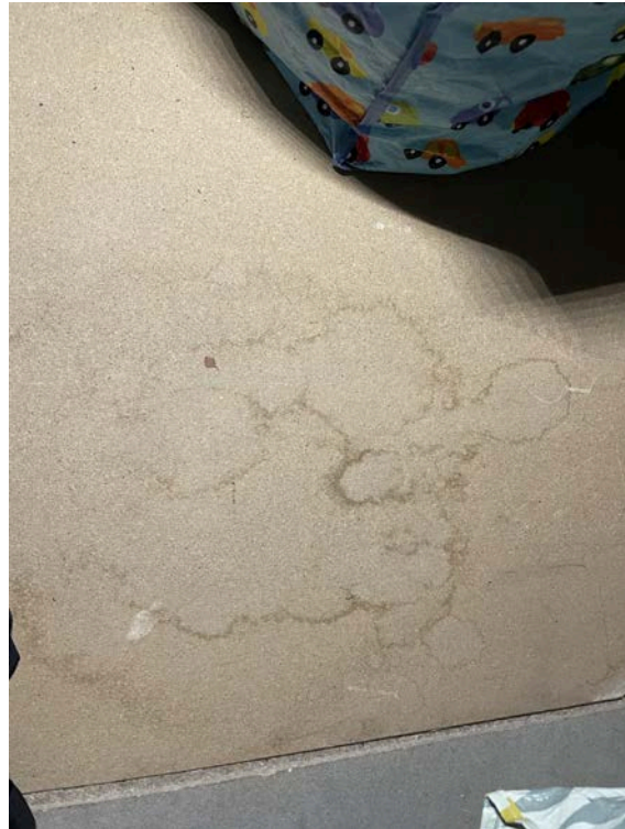
Det er påvist antatt eldre fuktskjolder på gulv i mørkeloft.
