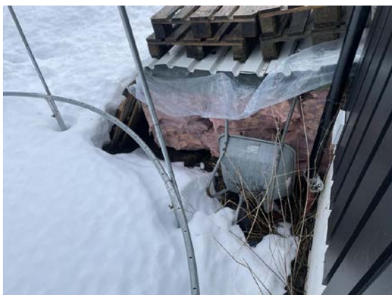
Der er lite / dårlig fall eller flatt ut fra bygningen.
