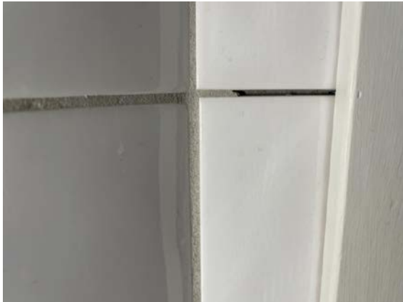
Manglende fuger i mellom keramiske fliser.
