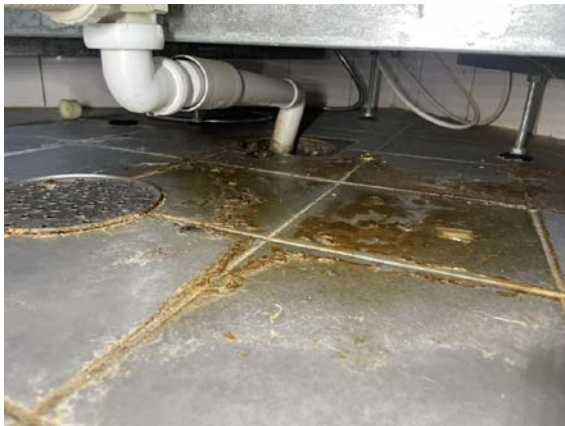
Membran kan ikke påvises i sluk eller i dokumentasjon.
