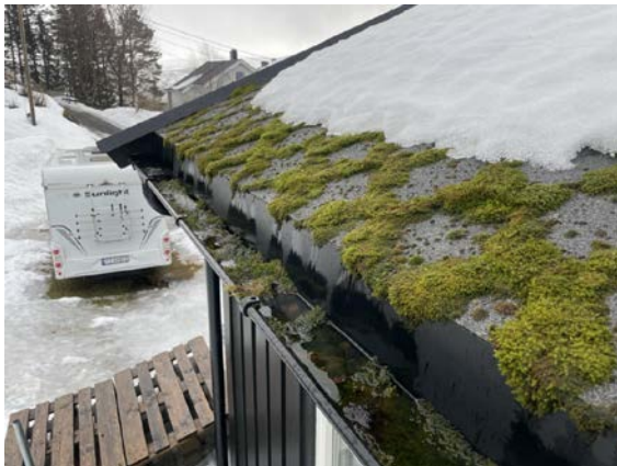
Takrenner er ikke rengjort, full av løv og sand.
