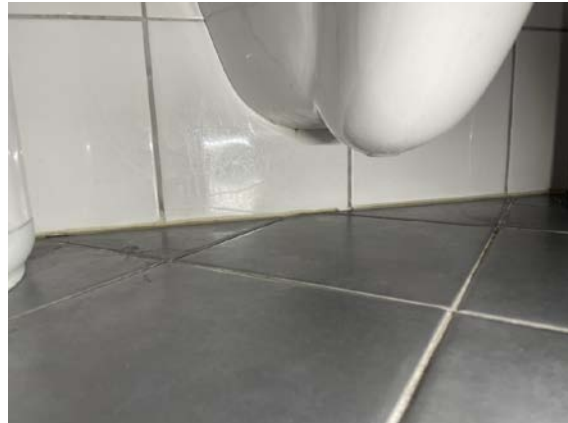
Ingen spalte, inspeksjonsmulighet eller dokumentasjon ved innebygget sistene.
