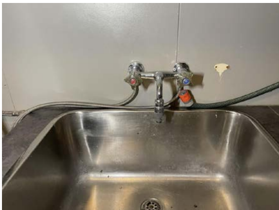
Våtsone vegg er ikke etablert.
