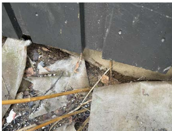
Der er lite / dårlig fall eller flatt ut fra bygningen.
