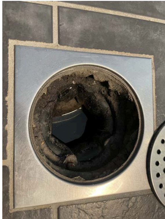
Membran kan ikke påvises i sluk eller i dokumentasjon.
