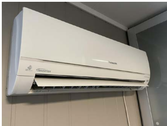
Luft-til-luft varmepumpe fra 2008 kjeller nærmer seg utløpsdato.
