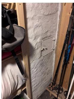
Sotluke i kjeller. På baksiden av denne pipen er pipeløpet kledd igjen med trepanel.
