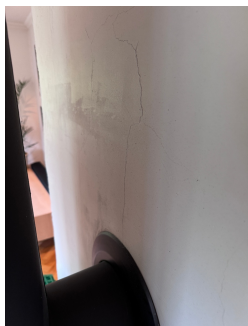
Sprekker i pipeløpet bak ildstedet.
