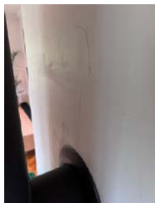
Sprekker i pipeløpet bak ildstedet.
