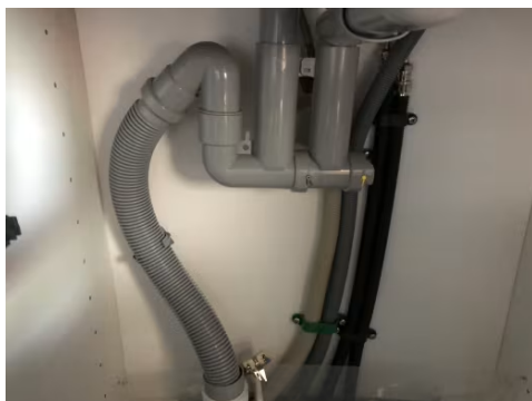
Boligen har hovedsakelig avløpsrør av plast fra 2018.
