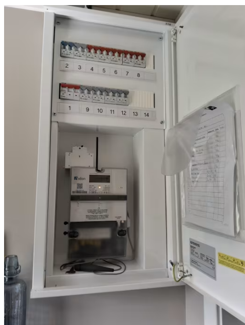
Sikringsskap er plassert i vindfang.
