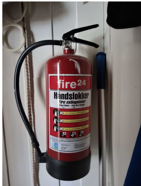
Brannslukningsapparat er plassert i trappegang til kjeller.
