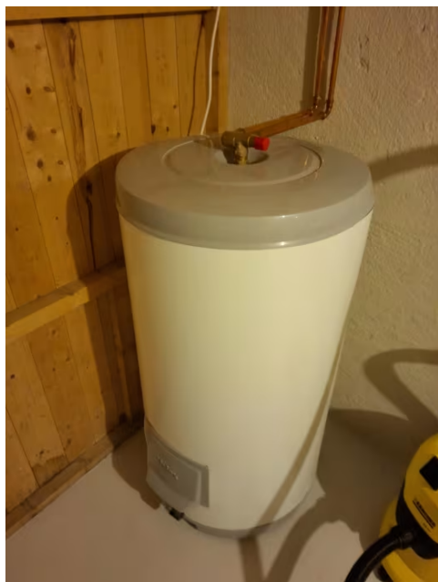
Varmtvannsbereder er plassert i kjeller.
