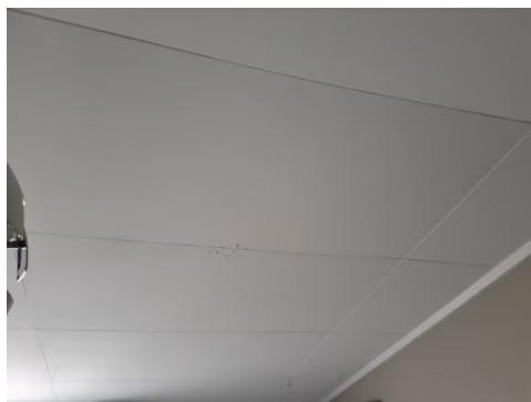
Takplater er feilmontert, og det registreres sig/buling.
