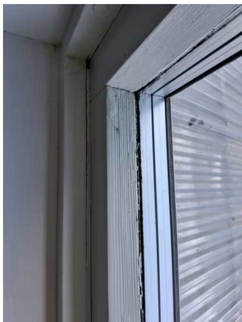
Det registreres tegn til kondens i enkelte vinduer.
