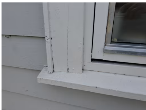
Det ingen klaring mellom omramming og vannbrettbeslag.
