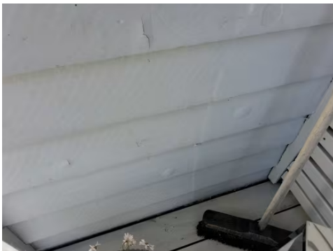
Det registreres stedvise malingsbobler.
