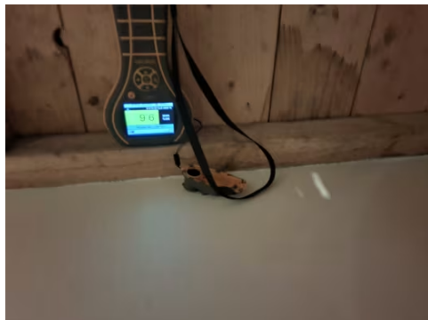
Bilde fra fuktmåling i delevegg.
