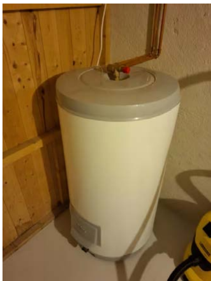
Varmtvannsbereder er plassert i kjeller.
