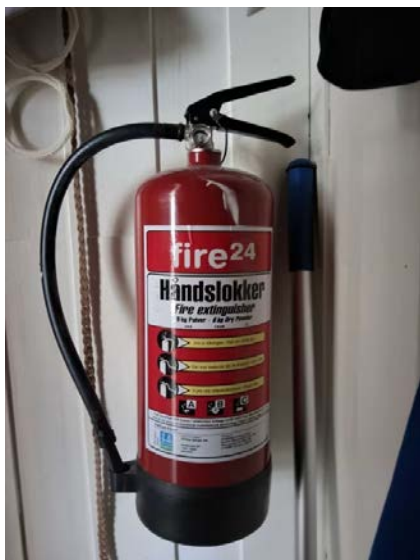
Brannslukningsapparat er plassert i trappegang til kjeller.
