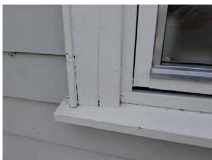
Det ingen klaring mellom omramming og vannbrettbeslag.
