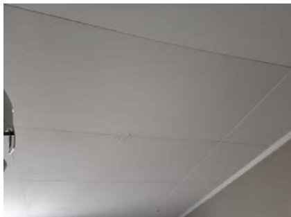
Takplater er feilmontert, og det registreres sig/buling.
