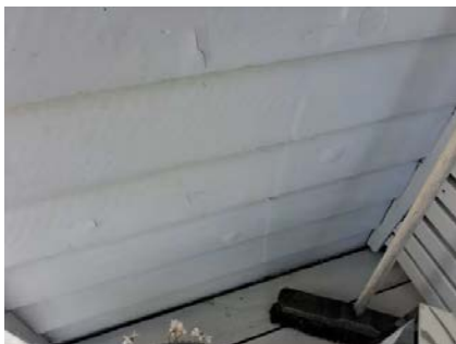
Det registreres stedvise malingsbobler.
