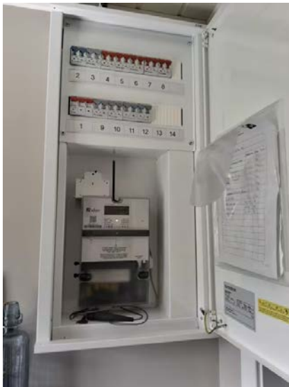
Sikringsskap er plassert i vindfang.
